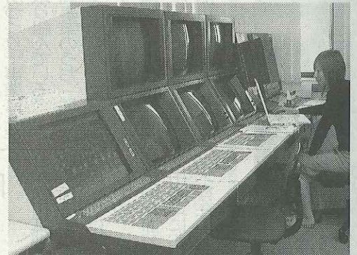
ものづくりの工程をコンピューターで管理制御する計装システム
